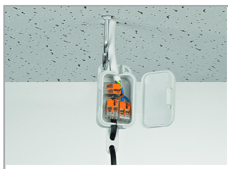
Connexion des luminaires suspendus dans les faux plafonds
